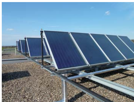
Solární systém na bytovém domě Praha
